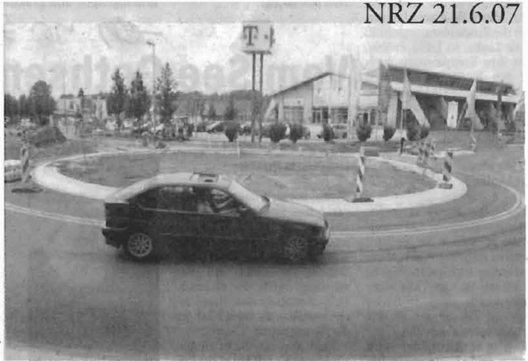
Der Kreisverkehr an der Max-Peters-Straße in Kaßlerfeld ist schon zur Hälfte befahrbar. Im September soll er eingeweiht werden. (Fotos: Friedhelm Geinowski)
